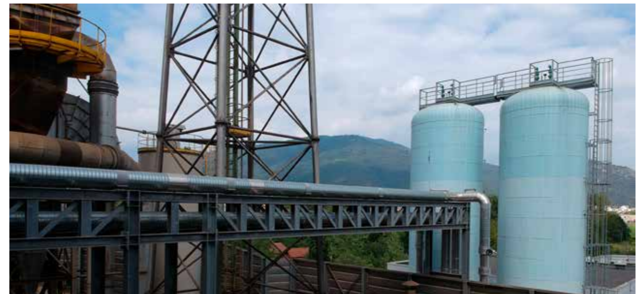
Alfa Acciai: sistema di tubazioni di alimentazione dell'impianto recupero calore dall'acciaiera e serbatoi di accumulo
